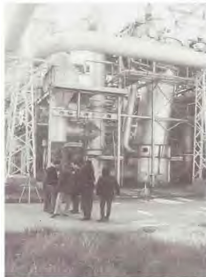
5.- Impianti dei gasometri
